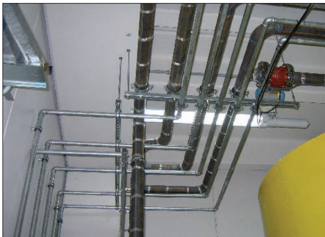
Tuberías de llenado para contenedores fijos
