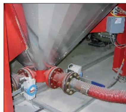
Sistema de calefacción
