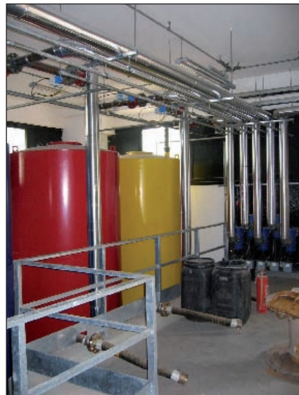
Tuberías de llenado para contenedores fijos
