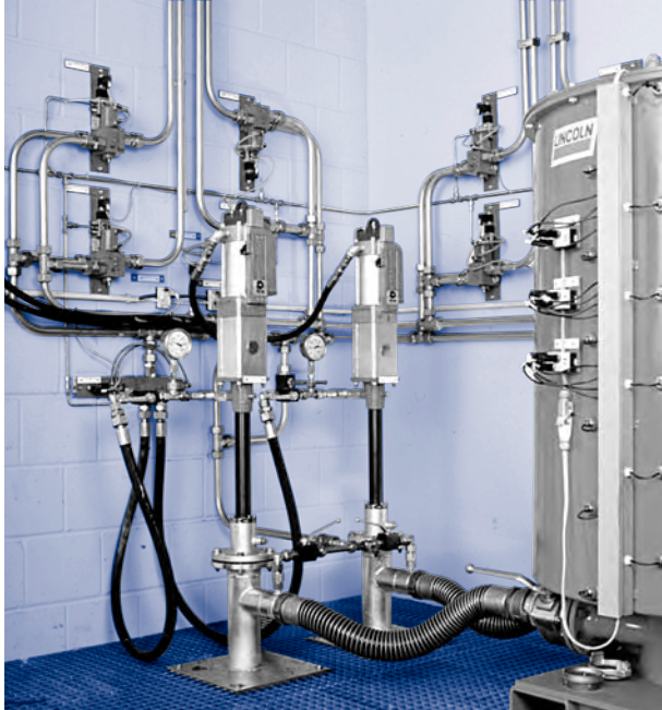
Estación principal de abastecimiento
